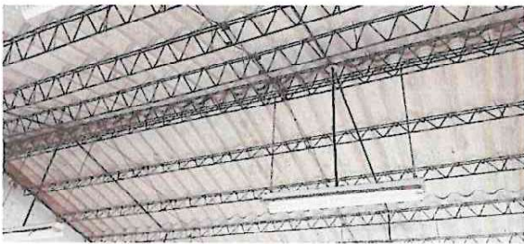
Foto 3: Sustitución de lamparas, mismas que están en mal estado, de las 9 unidades solo funcionan 2.
