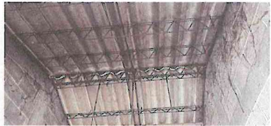
Foto 2: Sustitución de Estructura de Soporte. La estructura portante presenta corrosión y deterioro en su estructura.
