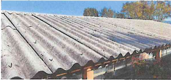
Foto 1: Lamina de Adbesto, urgente cambiar por lamina troquelada, tiene mas de 20 años de antigüedad
